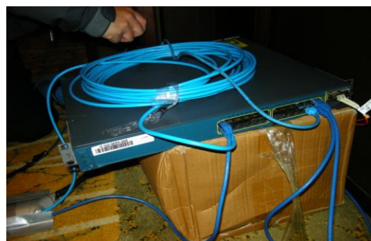
Terminal Room 交換器
