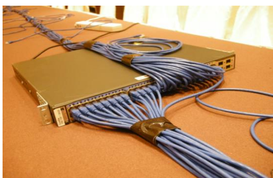
Terminal Room 交換器
