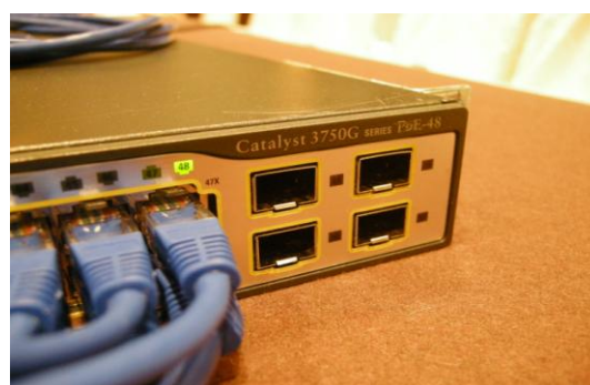
Terminal Room 交換器
